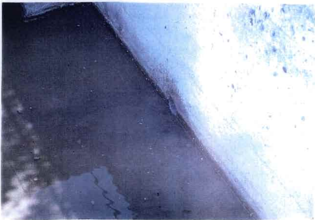
C.9 Perforación de muro para el desvío de ARU a la balsa almacén
