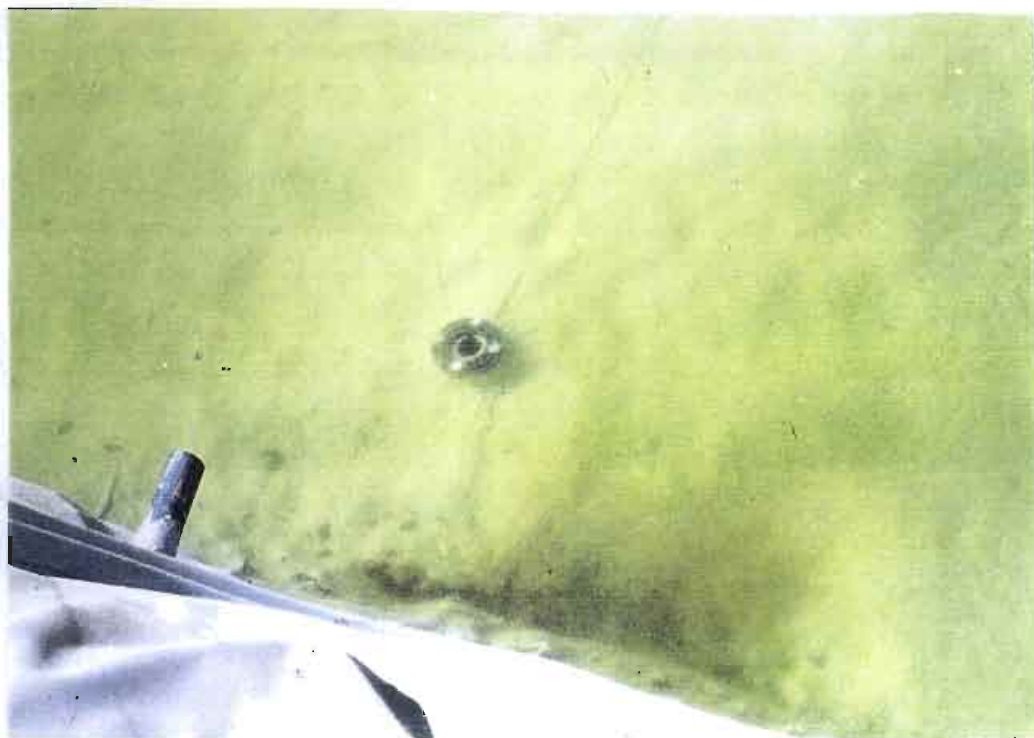
D. 15 Desagüe y rebosadero de la balsa de decantación
