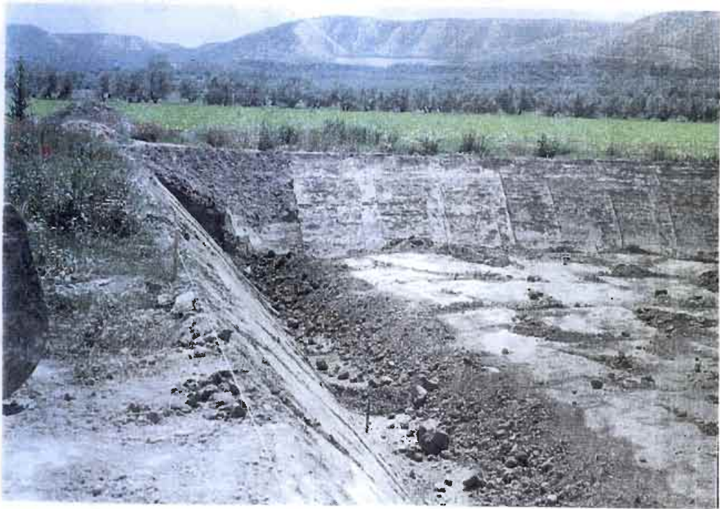
E.5 Taludes con 66% de inclinación
