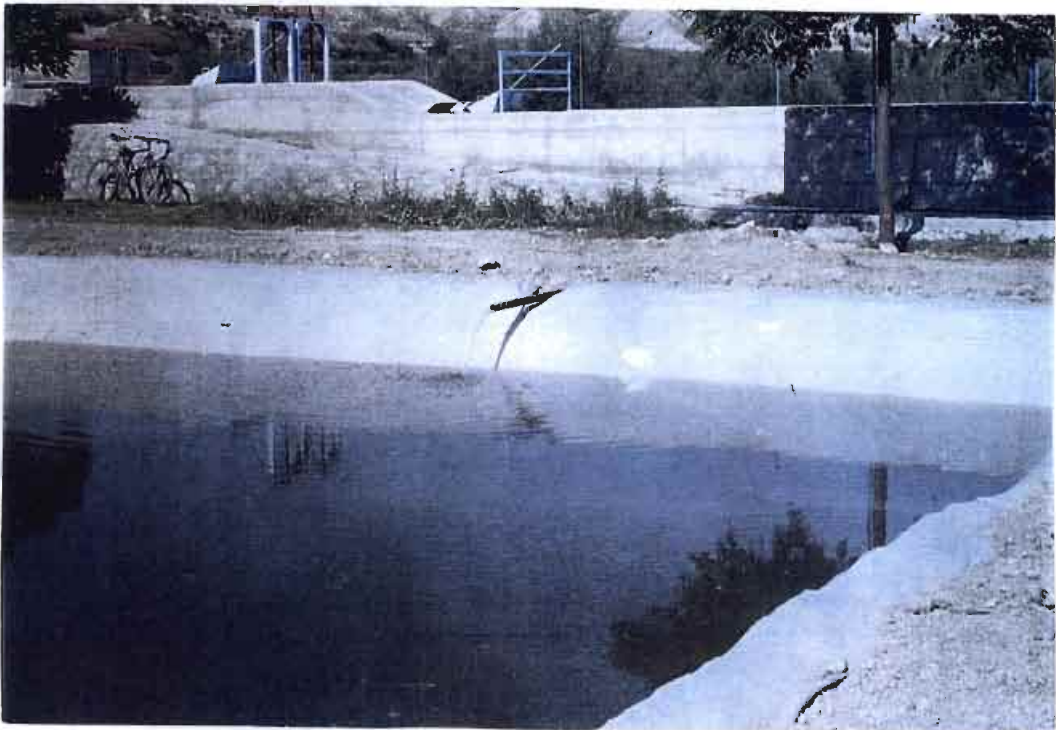
D.10 Alimentación de la balsa almacén
