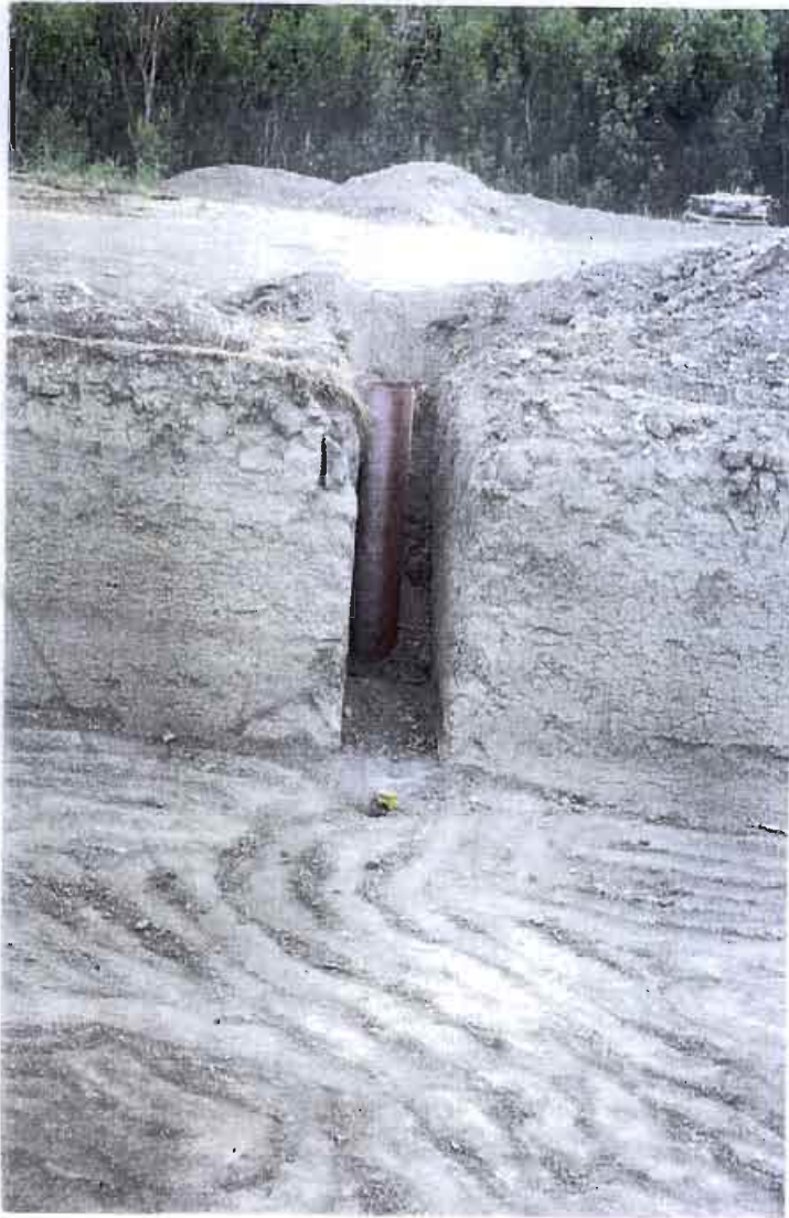
D.5 Desagüe de la balsa almacén y tubo de protección y acceso a la válvula de apertura y cierre
