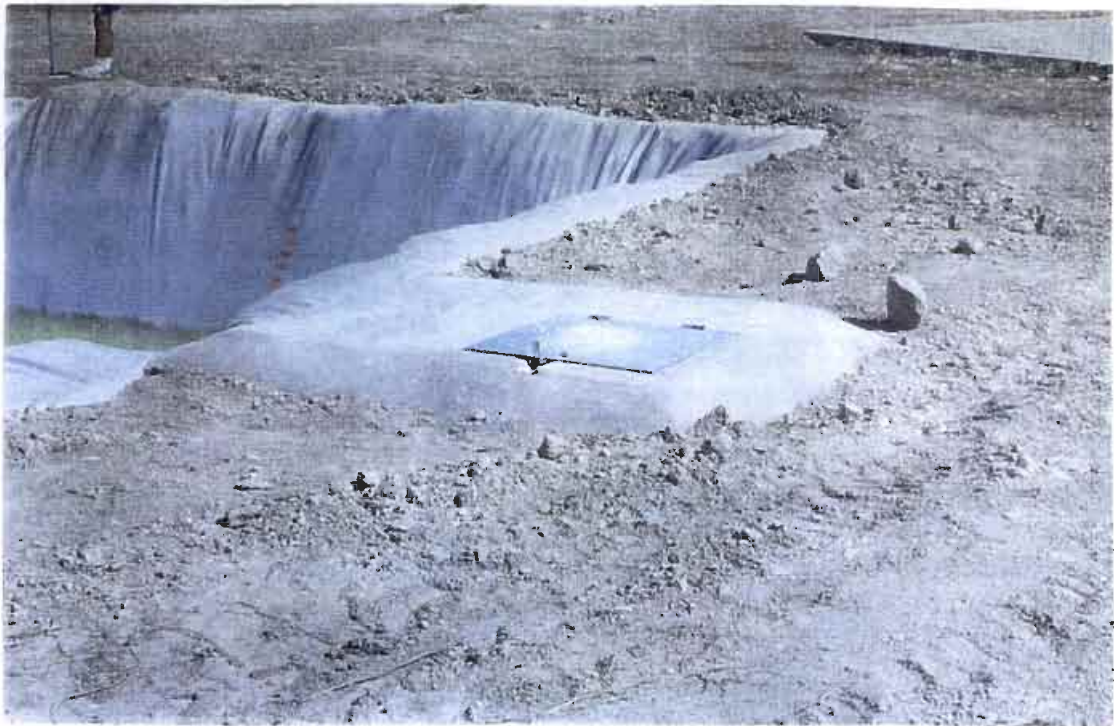
D.14 Arqueta de control y vaciado de la balsa de decantación
