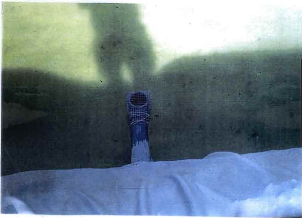
D.9 Tubería de trasvase de ARU de la balsa almacén a la balsa de decantación
