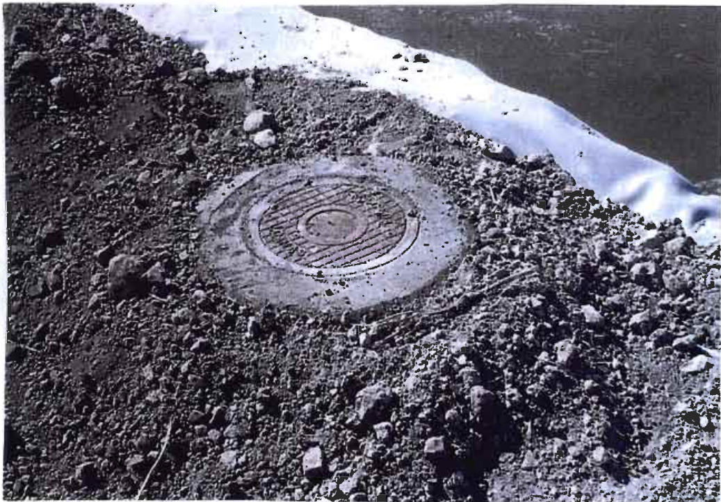
D.8 Arqueta de la válvula de desagüe de la balsa almacén
