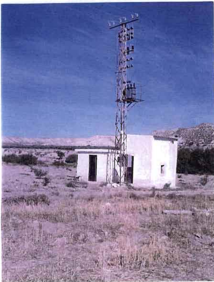
B.16 Pozo de abastecimiento de Dehesas de Guadix. Pozo utilizado para el control de calidad hidroquímico y piezométrico, aguas arriba del río Guadahortuna
